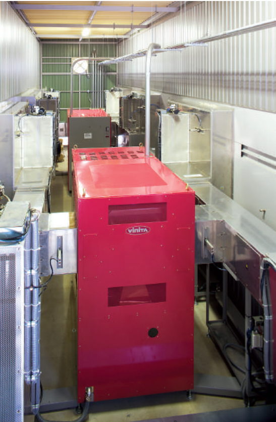
コントロール室の内部 Control Room 高周波発振装置、自動同調装置、切替え装置、 制御盤などを格納
