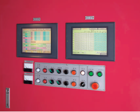
制御盤、コントロール装置 Control Panel and Control Equipment
